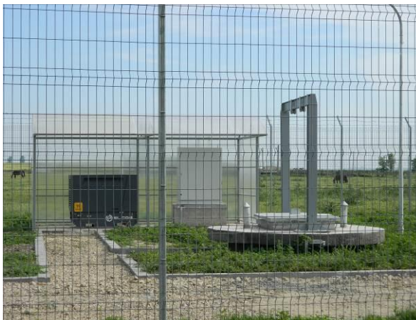
Figura nr. 2.10.36 Statie de pompare ape uzate Tufesti
