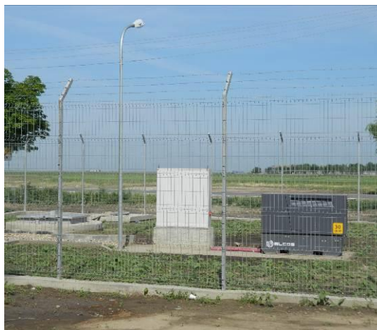
Figura nr. 2.10.37 Statie de pompare ape uzate Viziru
