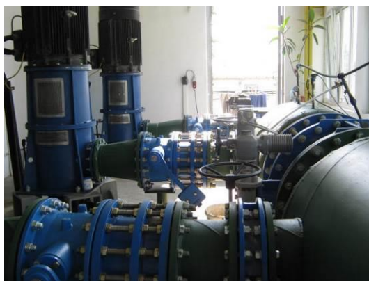
Figura 2.10.8 Statie de pompare Radu Negru reabilitata
