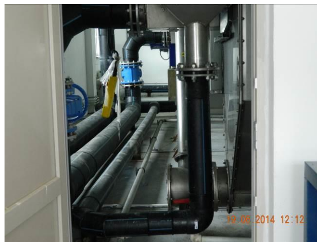
Figura nr. 2.10.25 Statie suflante (obiect nou)
