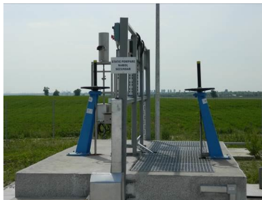
Figura nr. 2.10.33 Statie pompare namol
