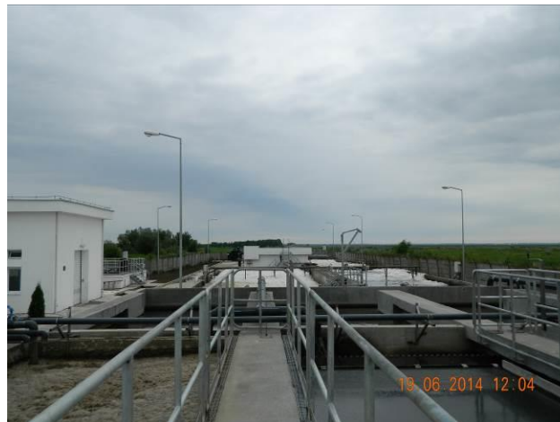
Figura nr. 2.10.23 Decantoare primare (obiect reabilitat)
