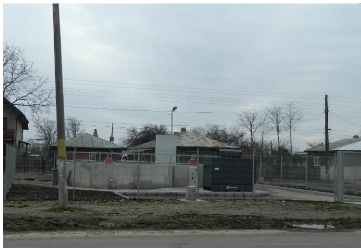
Figura nr. 2.10.27 Stație de pompare ape uzate Ianca
