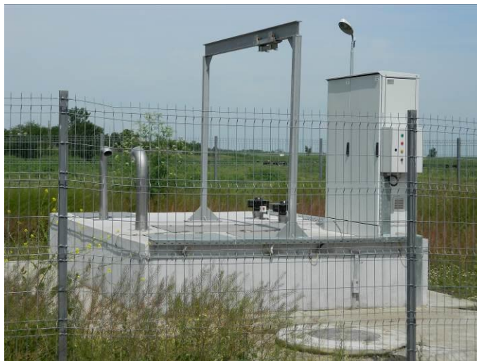
Figura nr. 2.10.28 Statie de pompare ape uzate Insuratei
