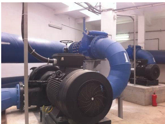
Figura 2.10.9 Statie de pompare Apollo reabilitata
